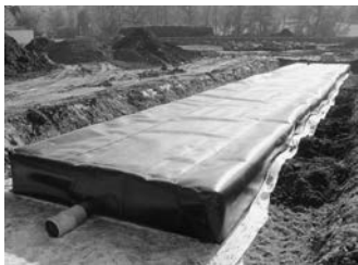
Bassin de rétention avec géomembrane
