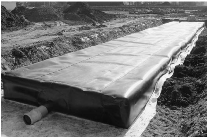
Rezervor ape pluviale învelit în folie
