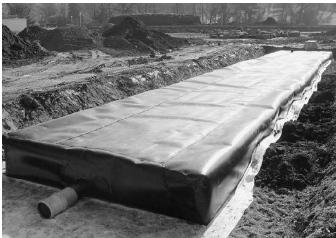
Regenwasserspeicher mit Folienummantelung
